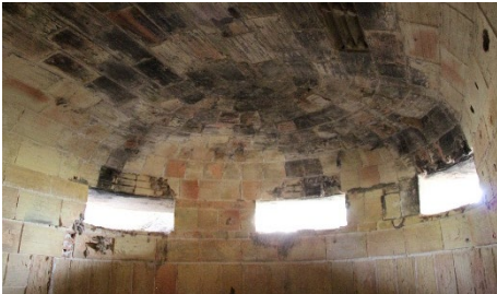
Fig. 13- Interior de un búnker con encofrado de ladrillo para el hormigón en Balsares, ca. 1937-1938, España (autor 2014).
