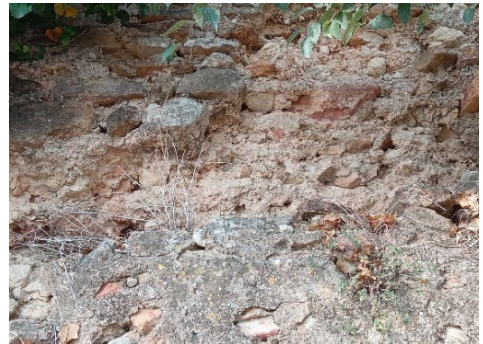
Fig. 17- Piedra irregular bajo la capa calicostrada. (Fotografía del autor, 2024).
