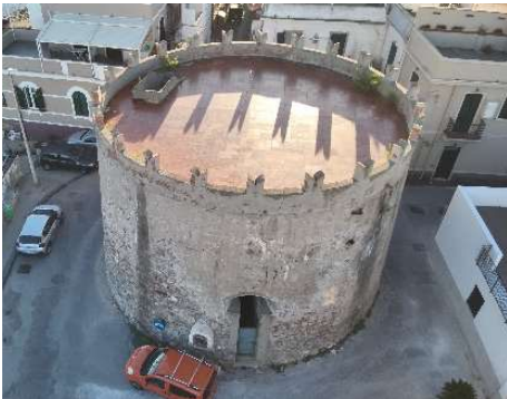
Fig. 10- Particolare della copertura della torre di Ganzirri. Si noti l'esiguo spessore del parapetto posticcio con merli ghibellini.
