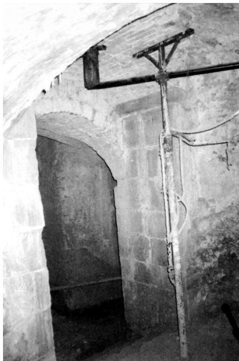
Fig. 13- Puntone Santa Maria Maddalena: troniera a cielo chiuso a quota + 0.30, con in primo piano la porta con gli stipiti in arenaria (Archivio Taddei, 1997).
