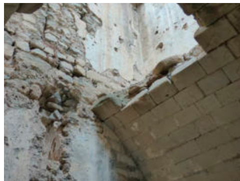
Fig. 4- Vista general y de detalle de las bóvedas interiores de la Torre del Homenaje (Vegas & Mileto, 2018)
