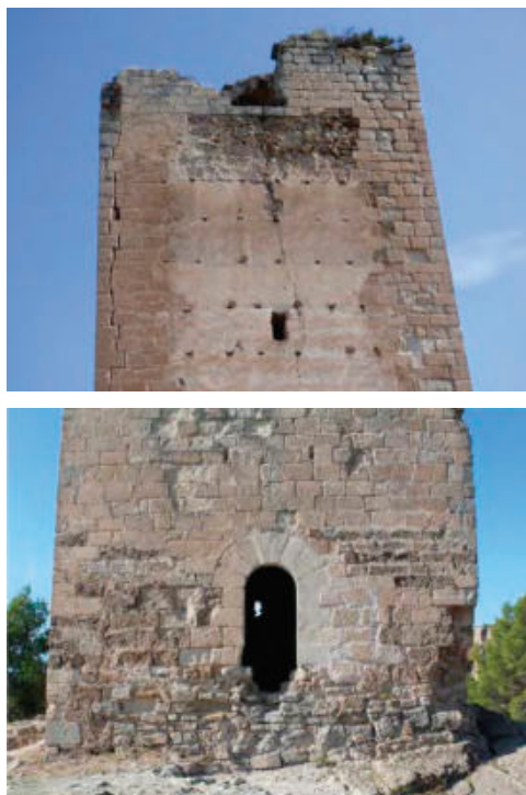
Fig. 7- Detalle de la erosión de la coronación y la tapia en la fachada sur y la erosión de la sillería en la base de la fachada norte (Vegas & Mileto, 2018)
