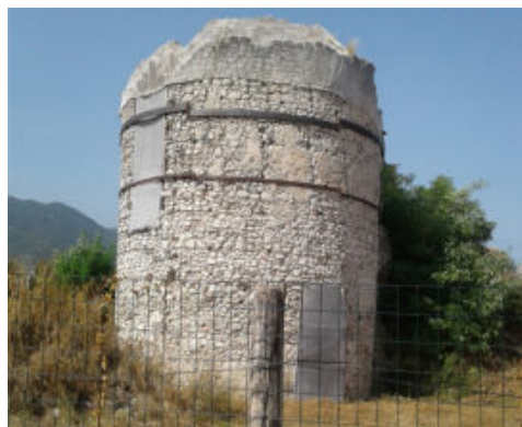
Fig. 7- Veduta di una delle torri del castello con le cerchiature ottocentesche di consolidamento (Romeo, 2021)
