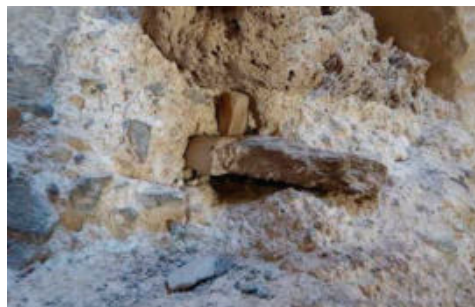
Fig. 3- Detalle de una media aguja fijada en la fábrica con un pasador en la parte interior del muro encontrado en el interior del muro meridional (Vegas & Mileto, 2018)
