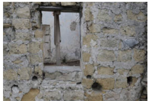
Fig. 9- Castel Volturmo (Ce), castello, fronte ovest, dettaglio di un paramento cinquecentesco con parziali rifacimenti del XVIII secolo a filari di bozzette (Guerriero, 2006)
